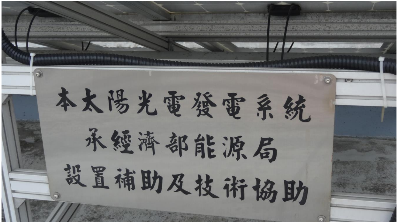
設置太陽能光電發電系統
